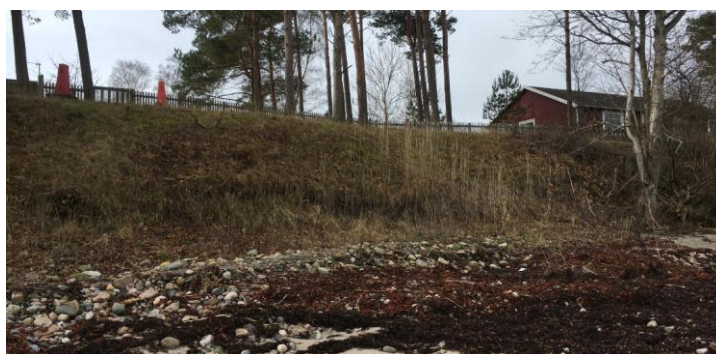
Figur 3-3 Öster om fastigheten Jonstorpsvägen 100 är erosionsskadorna på bakomliggande slänt avsevärt mindre. Bild tagen 2019-03-12.
