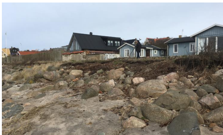
Figur 3-6 Kollapsad stenskoning längs Stelegången. Bild tagen 2019-03-12.
