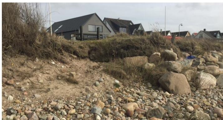
Figur 3-10 Delsträcka av kustlinjen längs med Strandlyckevägen som helt saknar erosions-skydd. Notera att erosionsskadorna är mindre, men påtagliga, längs den delvis raserade stenskoning. Bild tagen 2019-03-12.
