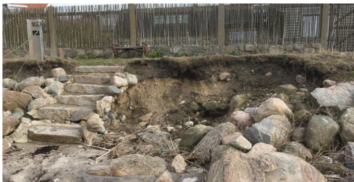
Figur 3-5 Erosionsskador som konsekvens av kollapsad stenskoning vid Stelegången. Bild tagen 2019-03-12.
