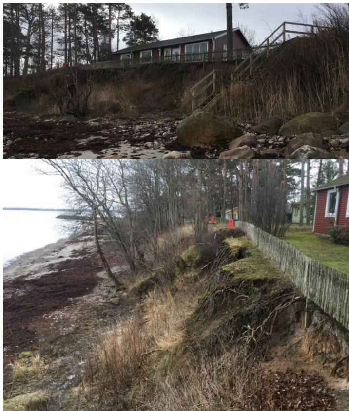
Figur 3-2 Rasbrant framför fastigheten Jonstorpsvägen 100, på den västra delen av planerad stensköning i Jonstorp. Bild tagen 2019-03-12.
